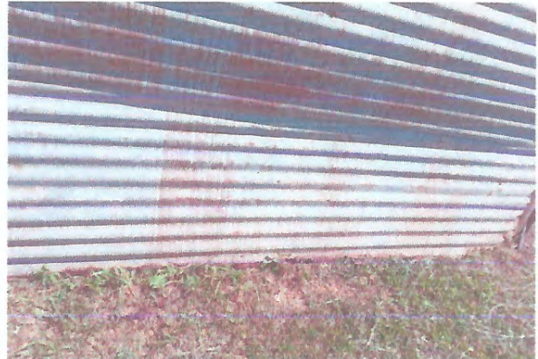
Foto 4: LAMINAS EN MAL ESTADO POR EL AGUA
