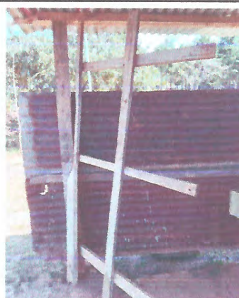
Foto 4: REGLAS Y LAMINAS EN MAL ESTADO
