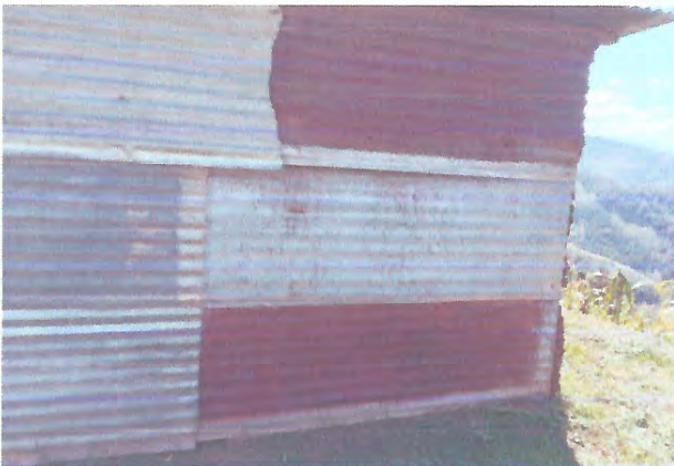
Foto 3: LAMINAS OXIDADAS Y PICADAS
