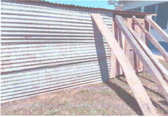
Foto 1: LAMINAS PICADAS Y EN MAL ESTADO.
