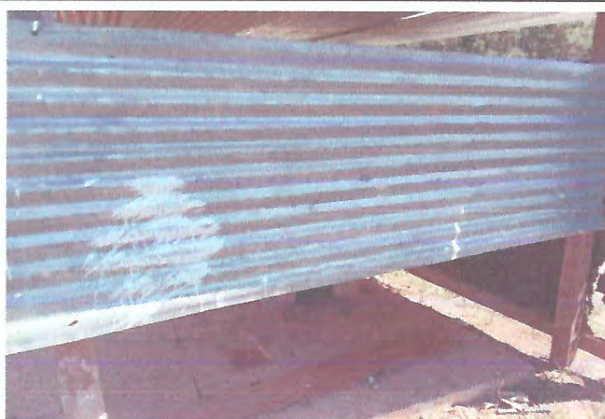
Foto 3: LAMINAS INCOMPLETAS Y OXIDADAS
